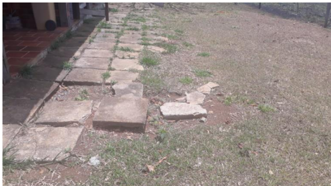
Imagem - 38-Passeios danificados Fazenda Girassol
