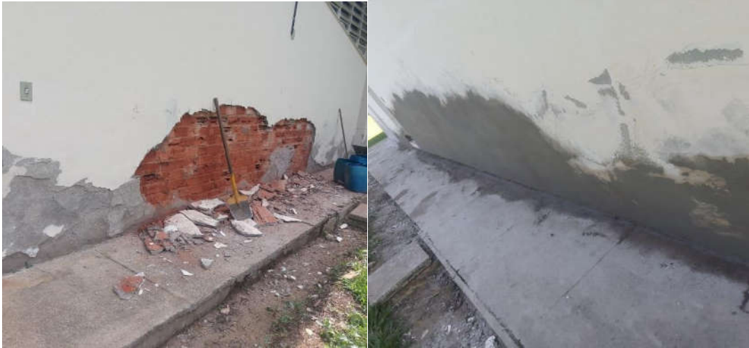
Figura 2. Estruturas área de camping. Manutenções em paredes danificadas com falhas estruturais, facilitando a entrada de água da chuva causando infiltrações que podem comprometer não apenas a integridade das paredes, mas também outras estruturas próximas.
