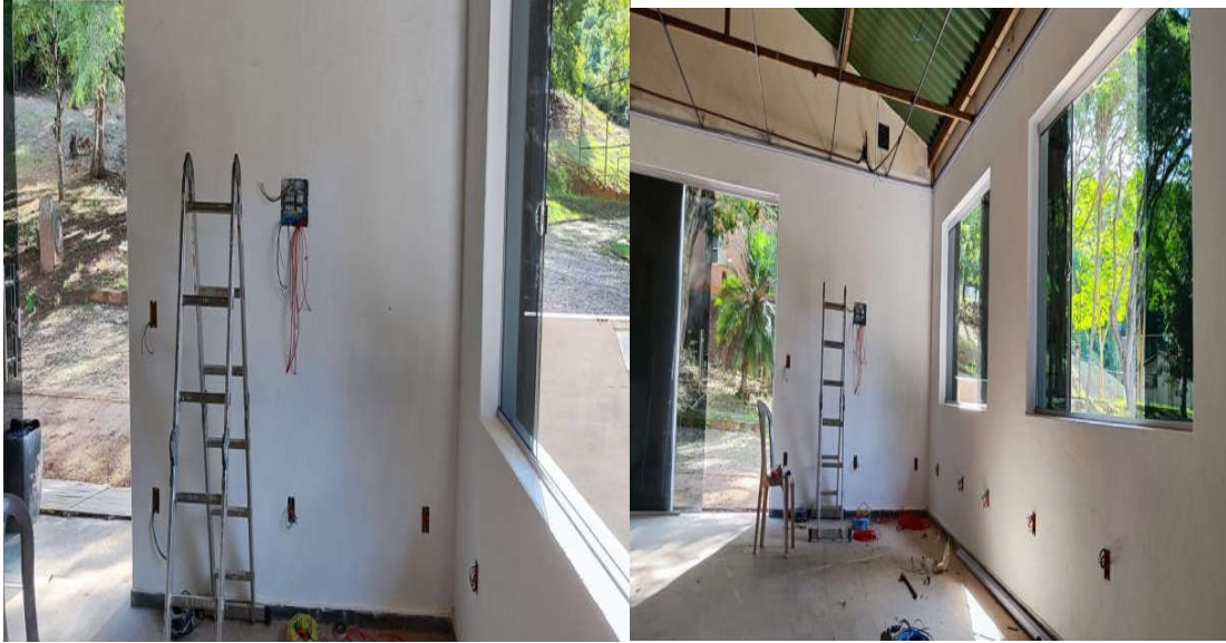
Figura 36. Manutenção com substituição de todo cabo elétrico sala de reunião florestal.
