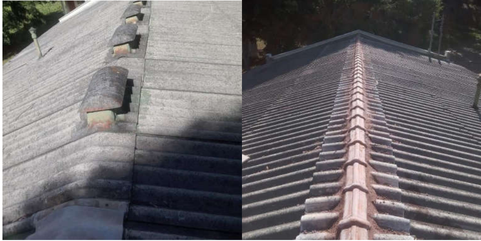
Figura 24. Sala de Reunião Florestal. Manutenção em toda estrutura do telhado, substituição de telhas quebradas.
