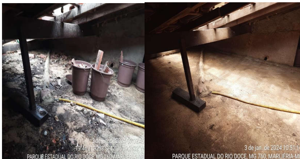
Figura 1. Alojamentos Centro de Treinamento. Limpeza de entulhos, resíduos de morcegos, baratas e escalções de repelentes eletrônicos. O acúmulo de entulhos e resíduos pode se tornar um terreno fértil para o crescimento de bactérias, fungos e outros microrganismos nocivos à saúde humana. Além disso, morcegos e baratas são conhecidos por serem portadores de doenças como a raiva, leptospirose, salmonelose e outras enfermidades que podem ser transmitidas aos humanos por meio de suas fezes, urina ou mordidas. A remoção desses materiais é crucial para evitar a propagação desses agentes patogênicos e proteger a saúde dos usuários.
