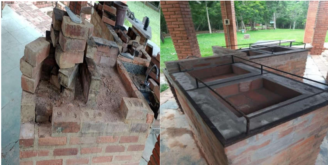
Figuras 10. Área de camping. Manutenção com reposições em todas as estruturas das churrasqueiras com tijolos refratários.
