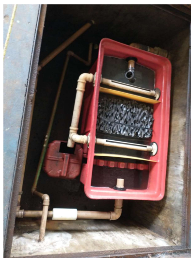
Foto 10 - Caixa Separadora (CSAO)
