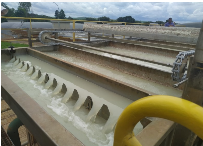
Foto 01. Estação de Tratamento de Esgoto
