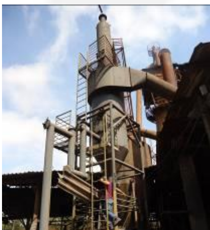
Foto 03. Sistema de limpeza de gás e chaminés
