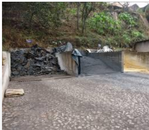
Foto 06. Baias para armazenamento de resíduos.
