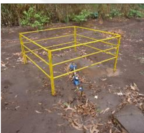
Foto 15. Poço tubular para captação subterrânea
