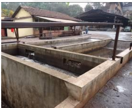
Foto 09. Tanque de decantação de sólidos.
