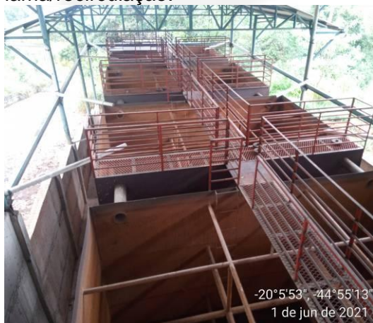
Foto 07. Tanques para aproveitamento de água pluvial.
