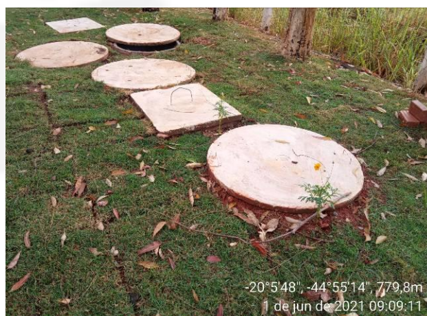
Foto 04. Estação de tratamento de efluentes sanitários.
