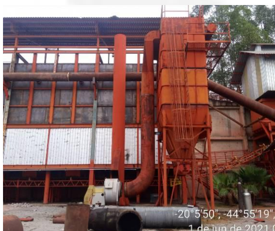
Foto 03. Filtro de mangas área de peneiramento.
