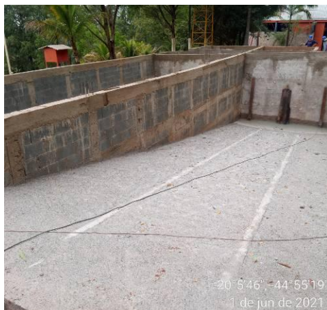
Foto 05. Tanque de decantação de lama/recirculação.
