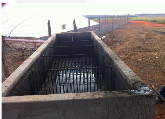
Foto 03. Print do relatório fotográfico acostado no processo – vista da caixa com grades para retenção de resíduos grosseiros.
