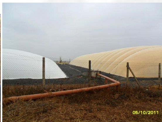
Foto 04. Print do relatório fotográfico acostado no processo - vista parcial dos 02 biodigestores.
