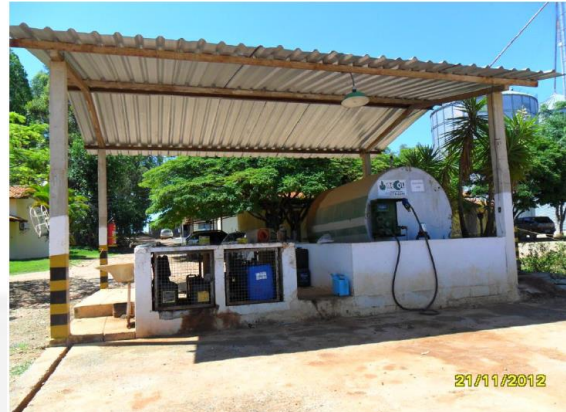
Foto 08. Print do relatório fotográfico acostado no processo - vista do tanque de abastecimento.
